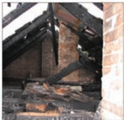
Štítová stěna z vápenopískového zdiva požáru bez problému odolala.
